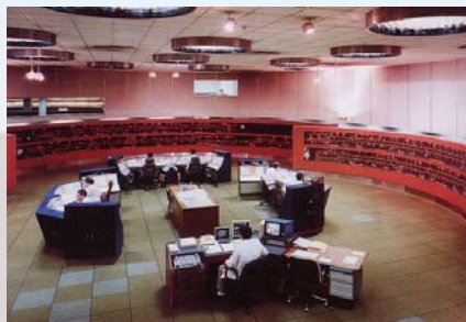
Poste de Commande Centralisée
